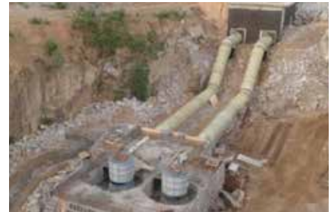
Conduites forcées et turbines
